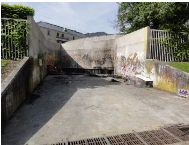
L'alimentation en eau du bassin B2 - ATM
