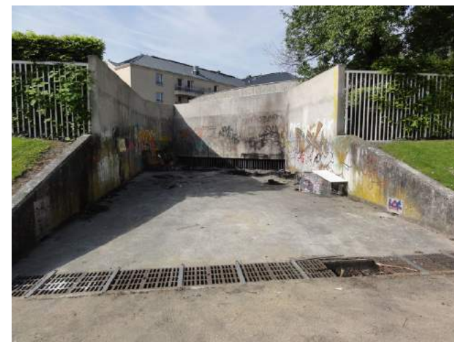
Au premier plan, la grille de vidange du bassin B2 - ATM
